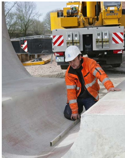
Die gleichmäßig dichte und glatte Betonoberfläche sorgt für eine erhöhte Fließgeschwindigkeit in den Abwasserkanälen und vermeidet auch „Stolperfallen“ ▶
