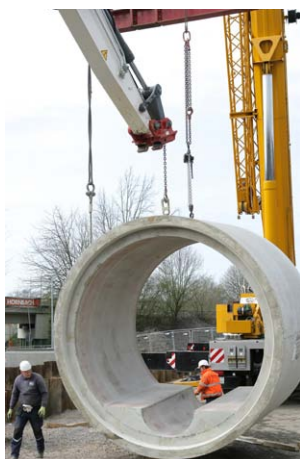
Schweres Gerät und spezielle Anker auf dem Rohrscheitel waren erforderlich, um die 38 t wiegenden Fertigteile in ihre Verlegeposition zu drehen
