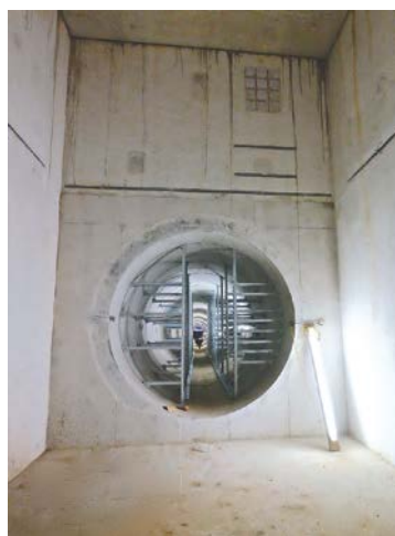
Blick aus einem Schachtbauwerk in den Infrastrukturkanal mit Montage- und Tragsystem.
