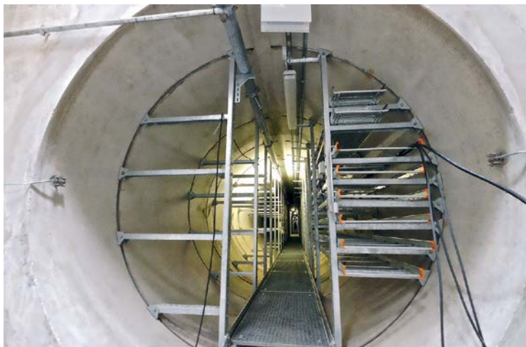
Der begehbare Infrastrukturkanal, ausgestattet mit einem flexiblen Montage- und Tragsystem vor der Belegung
