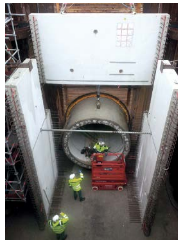
Zusammenfügen der bis zu 28 t schweren Wandelemente auf einer Stahlbeton-Bodenplatte. Im Bild oben links die Öffnung für die Durchführung der Leerrohre
