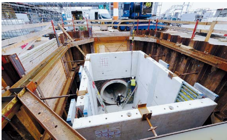
Erstmals wurde ein Fertigteilschacht dieser Dimension und einem Gesamtgewicht von 120 Tonnen mit Einzelelementen auf der Baustelle montiert.
