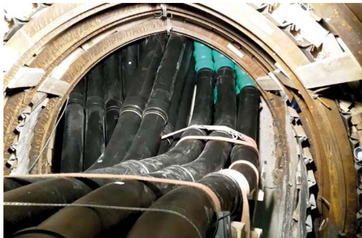
Leerrohrbelegung im Stollen
