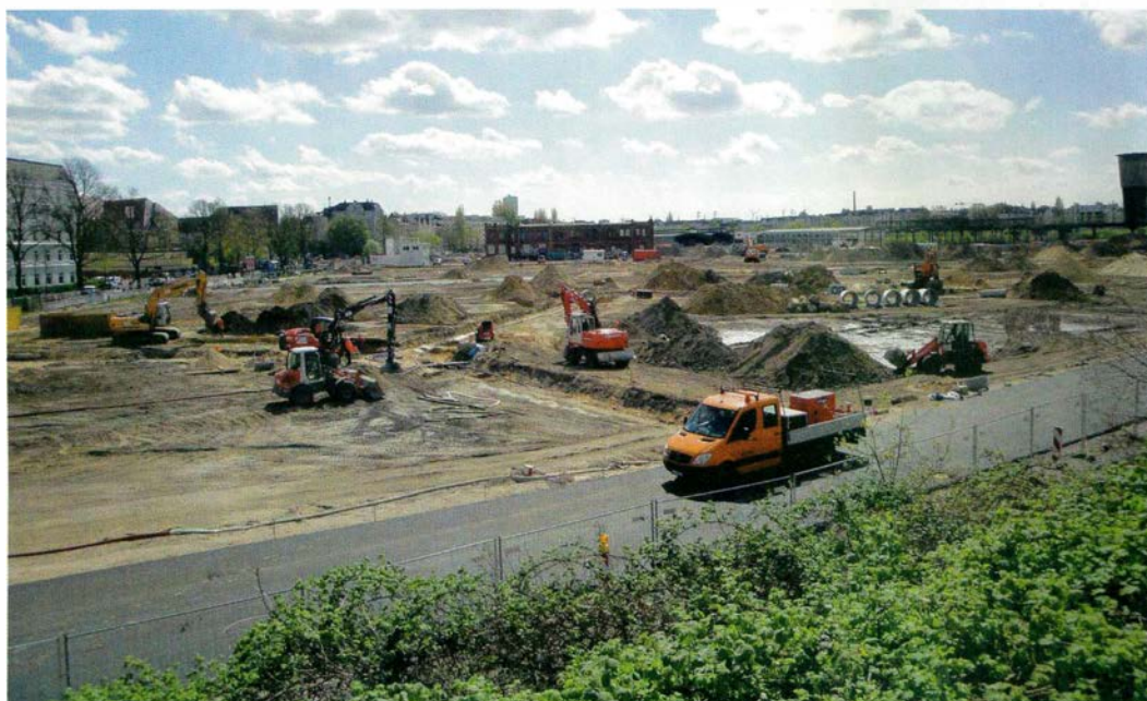
Im Herzen von Hamburg entsteht ein neuer Stadtteil – das Neubaugebiet Mitte Altona. Da durch die neue Bebauung die Flächenversiegelung deutlich erhöht wird, mussten zusätzliche Rückhaltemaßnahmen ergriffen werden.
