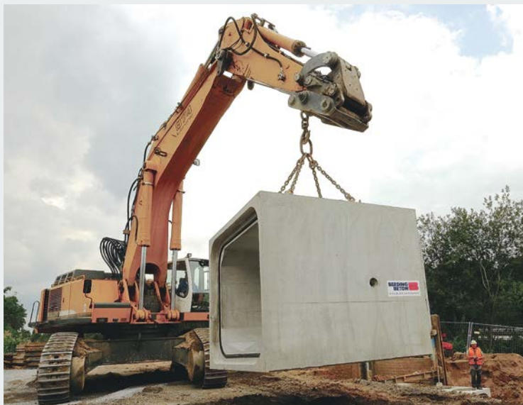
Ein mit 80 Tonnen kapitaler Bagger platziert die Fertigteile mit lichter Weite (WN) 2.500 mm und lichter Höhe (HN) 2.000 mm lagegenau in den vorbereiteten Rohrgraben.
