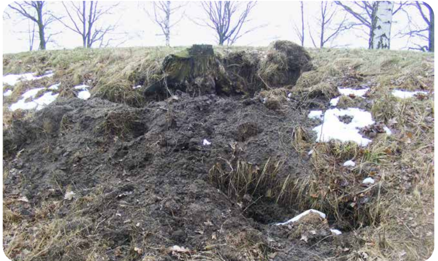
Bibergänge zerstören den Deichkörper ▲
