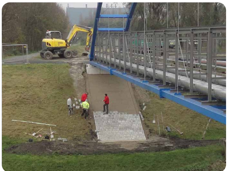
Bottrop, Zentrale Schlammabsetzungsanlage ▼
