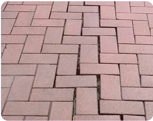
Verformungen der Pflasterdecke infolge fehlender Wasserdurchlässigkeit
