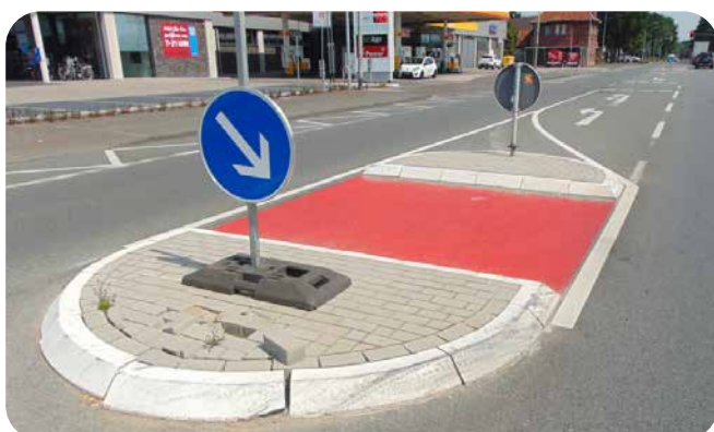
Schaden an einer herkömmlichen Querungsinsel
