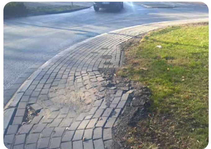
Schaden bei ungebundener Pflasterbauweise
