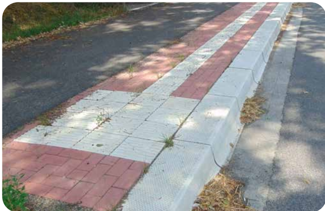
Fehlerhafte Ausrichtung der Rippenplatten
