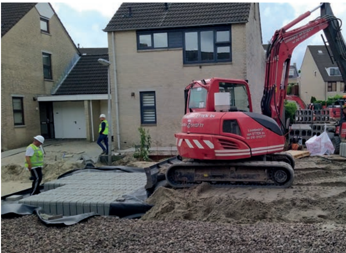
Die verlegte Fläche ist unmittelbar nach dem Setzen bereits von Baufahrzeugen befahrbar.
