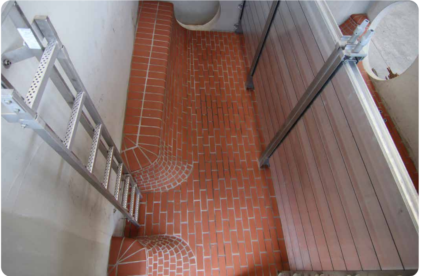
beSplit® als Rechteckbauwerk mit installierter Überfallschwelle
